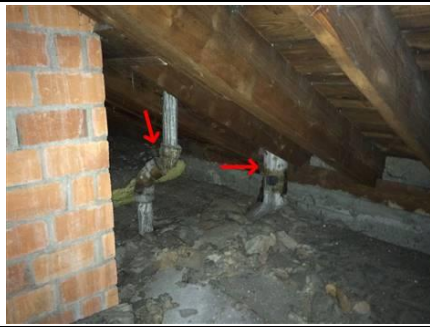
Photo n° PhA002 Localisation : 56 - 64 rue d'Alsace - Combles Ouvrage : Conduits de fluides (air, eau, autres fluides) Partie d'ouvrage : Conduits Description : Conduits Localisation sur croquis : Point002
