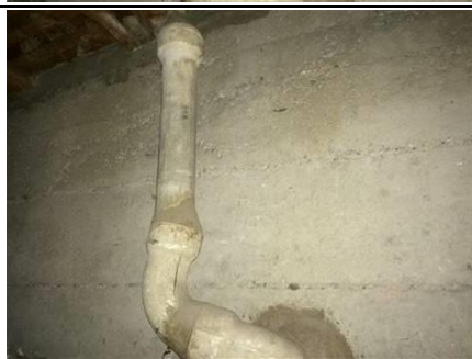
Photo n° PhA004 Localisation : 10 Anatole France - Combles Ouvrage : Conduits de fluides (air, eau, autres fluides) Partie d'ouvrage : Conduits Description : Conduits Localisation sur croquis : Point005
