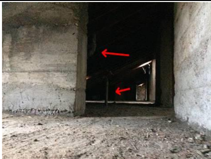
Photo n° PhA006 Localisation : 71 77 Alexandre Boutin - Combles Ouvrage : Conduits de fluides (air, eau, autres fluides) Partie d'ouvrage : Conduits Description : Conduits Localisation sur croquis : Point007
