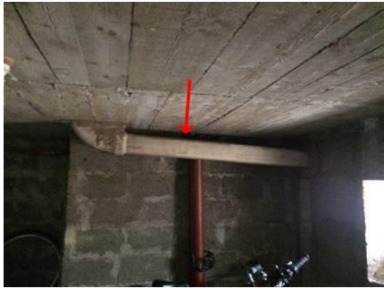
Photo n° PhA001 Localisation : 56 - 64 rue d'Alsace - Cave parties communes Ouvrage : Conduits de fluides (air, eau, autres fluides) Partie d'ouvrage : Conduits Description : Conduits Localisation sur croquis : Point001
