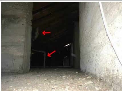
Photo n° PhA006 Localisation : 71 77 Alexandre Boutin - Combles Ouvrage : Conduits de fluides (air, eau, autres fluides) Partie d'ouvrage : Conduits Description : Conduits Localisation sur croquis : Point007
