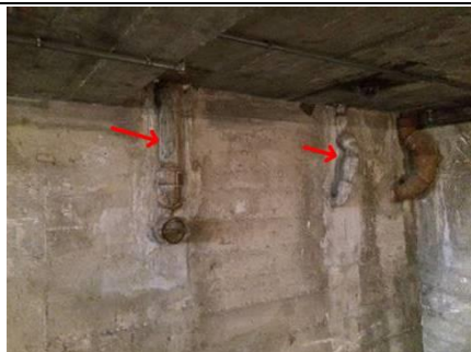
Photo n° PhA003 Localisation : 10 Anatole France - Cave parties communes Ouvrage : Conduits de fluides (air, eau, autres fluides) Partie d'ouvrage : Conduits Description : Conduits Localisation sur croquis : Point004
