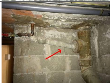
Photo n° PhA005 Localisation : 71 77 Alexandre Boutin - Cave parties communes Ouvrage : Conduits de fluides (air, eau, autres fluides) Partie d'ouvrage : Conduits Description : Conduits Localisation sur croquis : Point006
