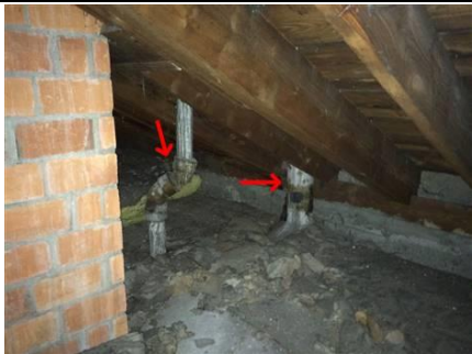
Photo n° PhA002 Localisation : 56 - 64 rue d'Alsace - Combles Ouvrage : Conduits de fluides (air, eau, autres fluides) Partie d'ouvrage : Conduits Description : Conduits Localisation sur croquis : Point002
