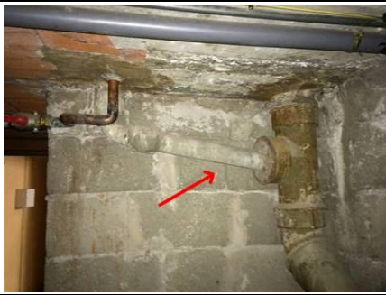
Photo n° PhA005 Localisation : 71 77 Alexandre Boutin - Cave parties communes Ouvrage : Conduits de fluides (air, eau, autres fluides) Partie d'ouvrage : Conduits Description : Conduits Localisation sur croquis : Point006
