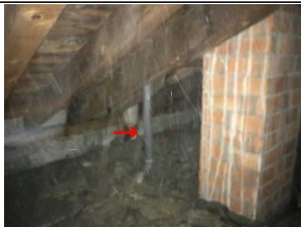
Photo n° PhA002 Localisation : 56 - 64 rue d'Alsace - Combles Ouvrage : Conduits de fluides (air, eau, autres fluides) Partie d'ouvrage : Conduits Description : Conduits Localisation sur croquis : Point002
